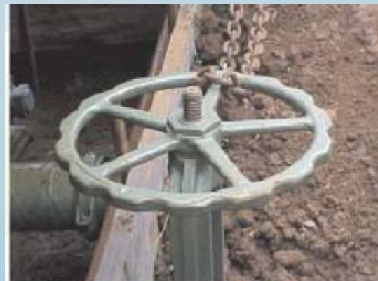
Válvula Gaveta Instalada na Sucção
