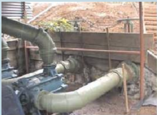
Sucção e Recalque da bomba
