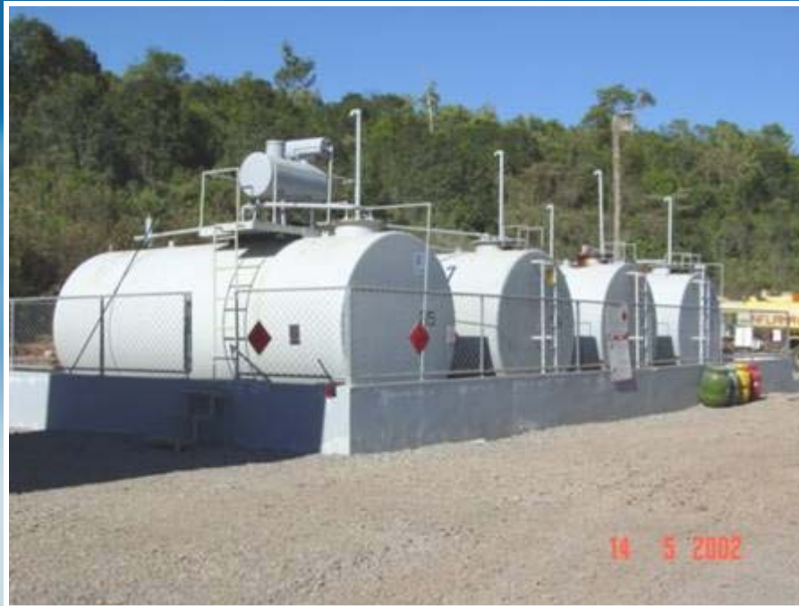
Armazenamento de Combustível – mureta de contenção impermeabilizada e caixa separadora de água / óleo
