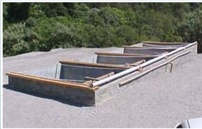
Leito de secagem de lodo
