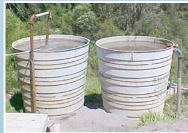
Tanques de decantação
