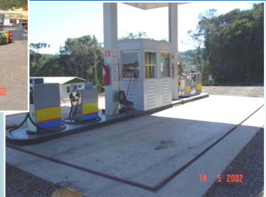
Canaletas para contenção de possíveis derramamentos no abastecimento
